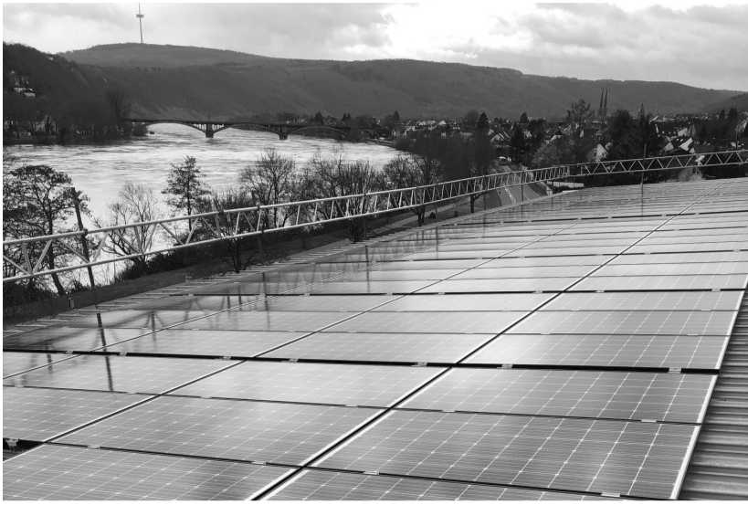
Die größte Photovoltaik-Anlage in Koblenz-Güls wurde im April auf dem Dach des Autohaus Scherhag in Betrieb genommen.
